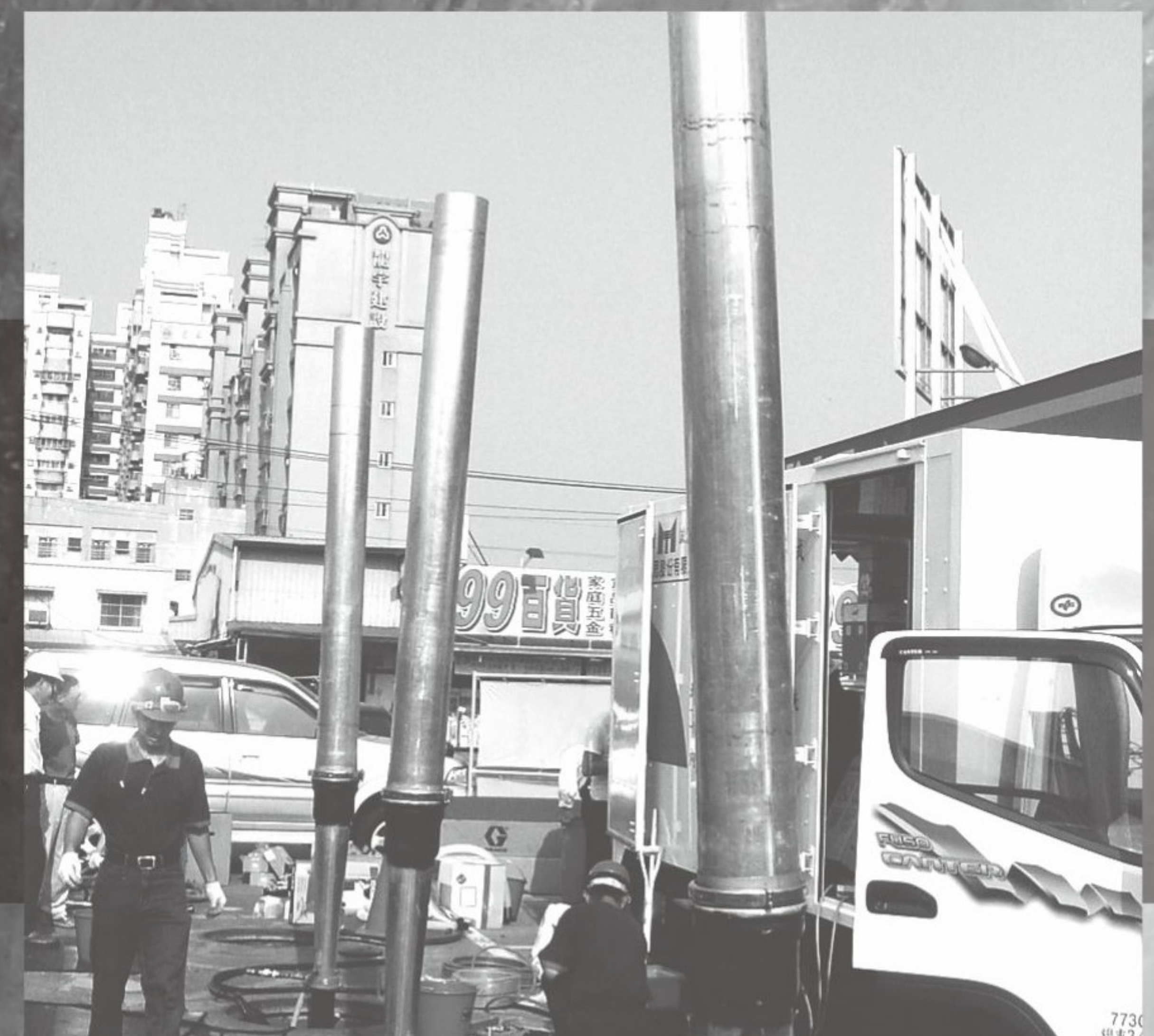
▲ 高速排氣導管設備
